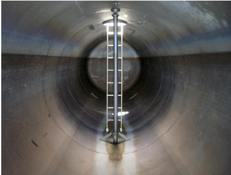
Bild 12: Renhetsgrad 2.3.x.x Rostfri CrNi-ståltank som missfärgats fullständigt av godsslaget (natriumhydroxidlösning)
