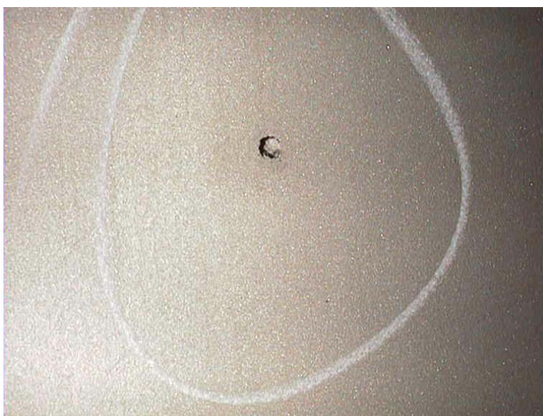
Figura 20: Grado de pureza 3.6.x.x Corrosión por picadura en la pared
