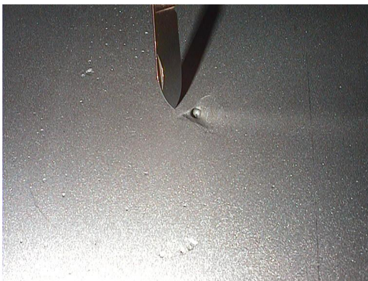
Figura 22: Grado de pureza 3.6.x.x Corrosión por picadura en la pared
