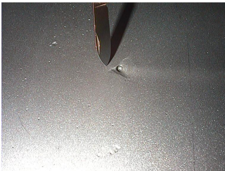
Obrázek 22: Stupeň čistoty 3.6.x.x Důlková koroze ve stěně
