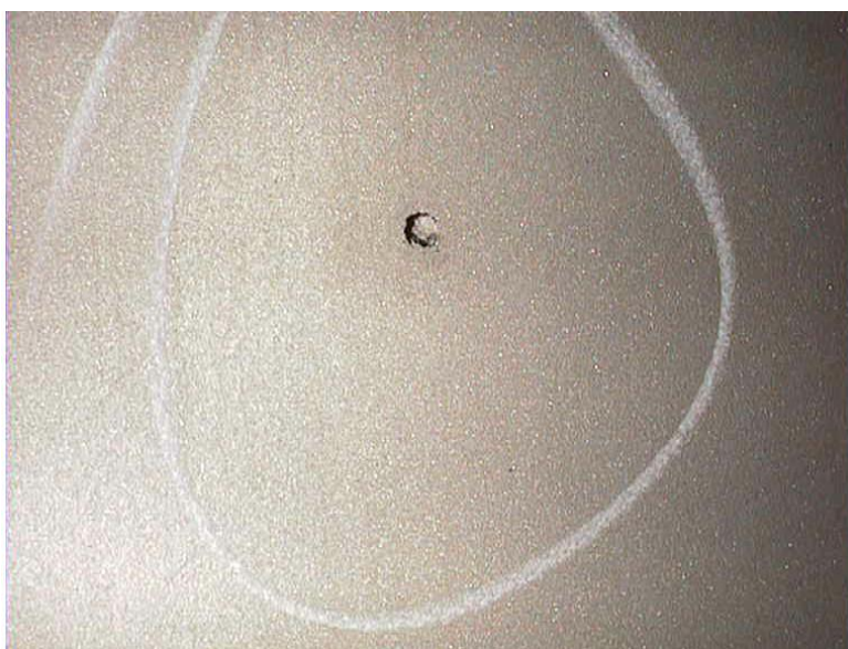
Obrázek 20: Stupeň čistoty 3.6.x.x Důlková koroze ve stěně
