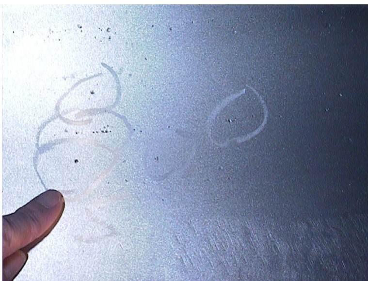
Obrázek 23: Stupeň čistoty 3.6.x.x Důlková koroze ve stěně
